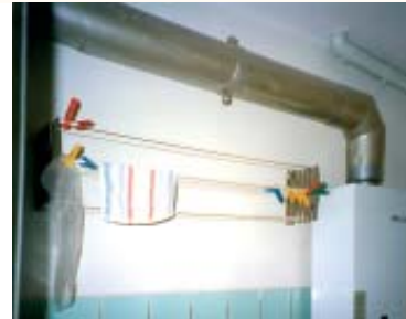
Ein Bad vor der Sanierung – es wimmelte vor Rohren!
